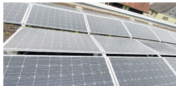
Der Ausbau der Fotovoltaiknutzung soll weiter vorangetrieben werden.
